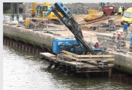
Реконструкция причального сооружения в г. Гамбурге, Германия. Установка анкеров ТИТАН с помоста, прикрепленного к новой шпунтовой стенке.
