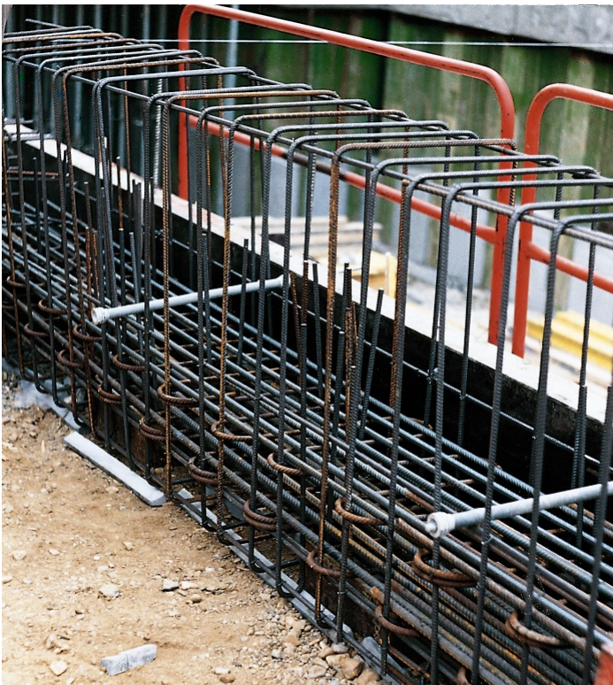
Bauzustand: Bügel- und Spaltzugbewehrung sichtbar.
